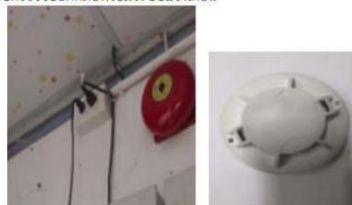
มีระบบตรวจจับอัคคีภัยพร้อมระบบแจ้งเตือน
