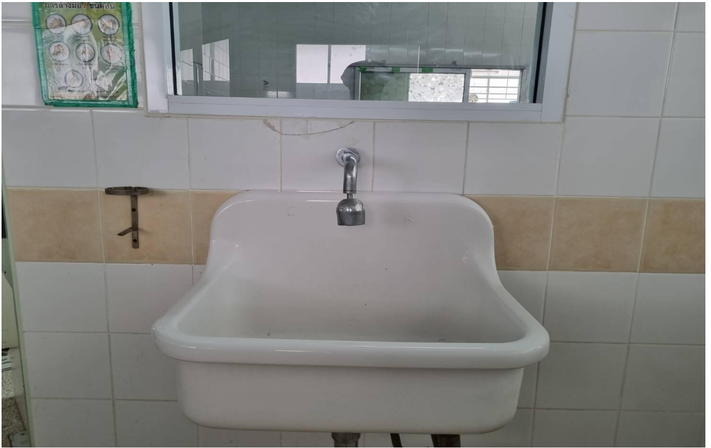
11.9อ่างฟอกมือชนิดที่ไม่ใช้มือเปิด ปิดน้ำ
