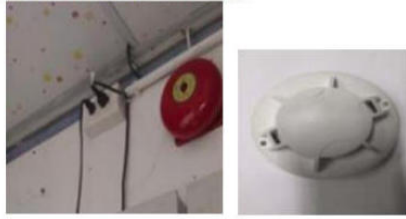
มีระบบตรวจจับอัคคีภัยพร้อมระบบแจ้งเตือน
