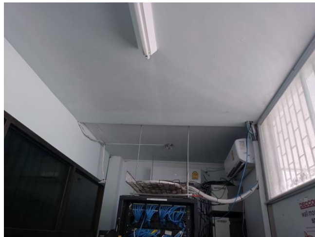
เจ้าหน้าที่ดูแลห้อง Data center
